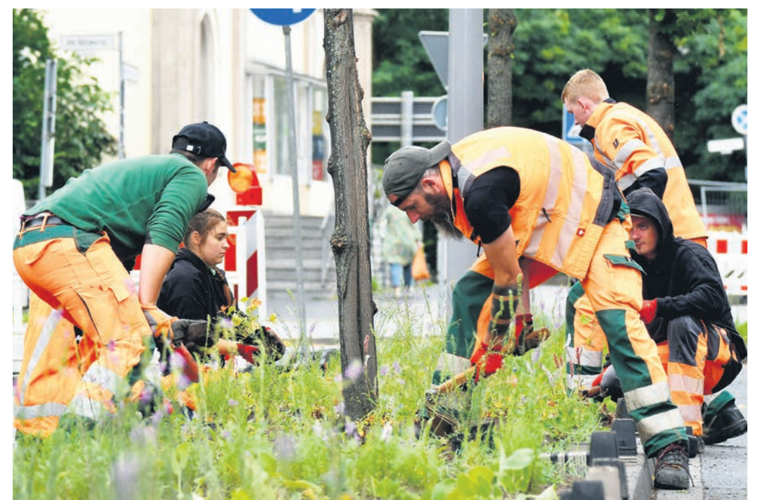
Auf 90 Quadratmetern haben Stadtmitarbeiter jetzt etwa 900 Pflanzen in den Boden gebracht, in dem künftig auch mehr Regenwasser versickern soll. Foto: Christina Hinzmann
